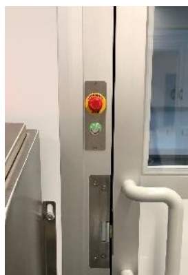
Zutrittsstür Reinraum freigegeben
