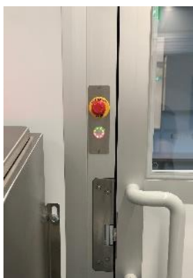
Zutrittsstür Reinraum gesperrt
